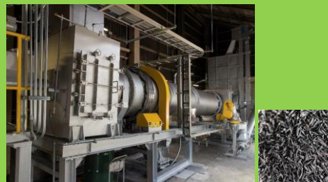
籾殻を用いたバイオ炭製造施設
