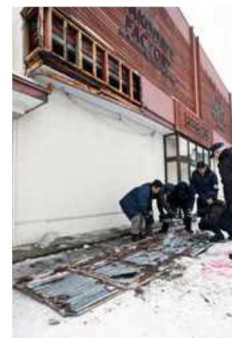
落下した外壁
