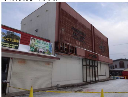
外壁落下後の建物写真①
