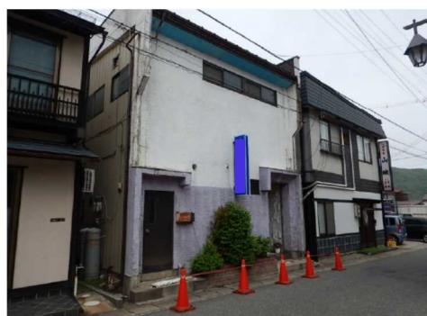
外壁落下建物全景
