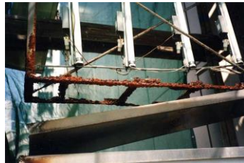
↑看板底部の脱落
