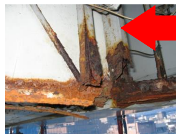
↑板面裏側のサビ、腐食。サビによる腐食はミルフィーユ状に剥がれ崩落する恐れも。
