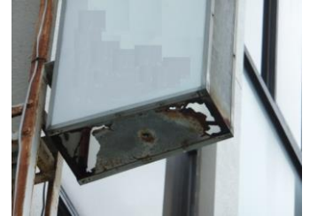
↑看板底部の留め具が壊れるとアクリル板が抜け落ちる原因にも。
