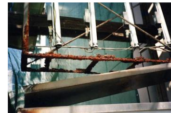
↑看板底部の脱落
