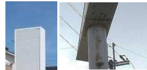
↑看板本体からポールへの汚ダレがあると、接合部にサビや腐食が進行する恐れ。
