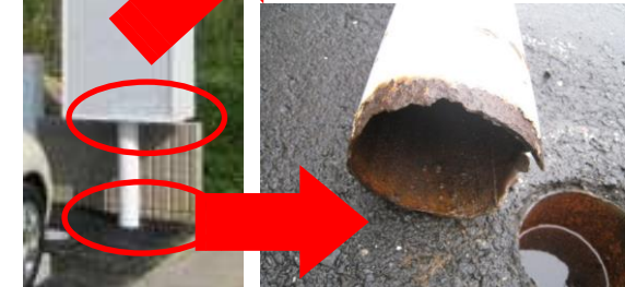
↑柱根元のサビを放置し、倒壊。
