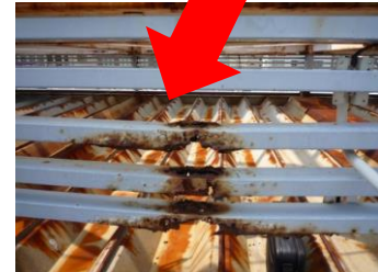
↑目隠しルーバーのサビ・腐食。
