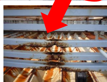
↑目隠しルーバーのサビ・腐食。
