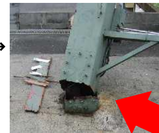
折れた柱の根元。点検口のボルト穴からサビが入り腐食して、鉄骨が破断した。
