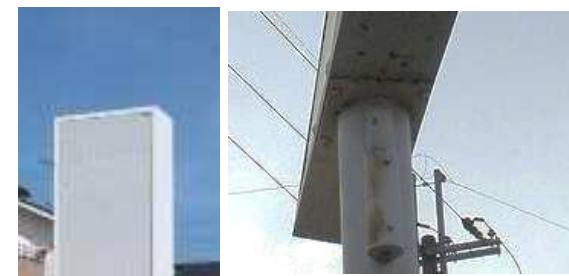
↑看板本体からポールへの汚ダレがあると、接合部にサビや腐食が進行する恐れ。
