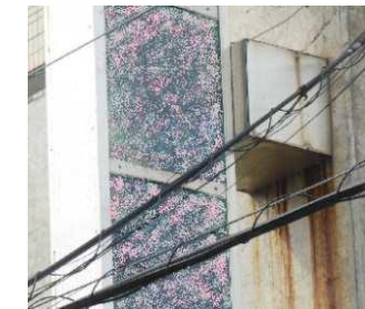
←ブラケット下に汚ダレが見られると、内部の取付金具にサビや腐食の可能性もある。
