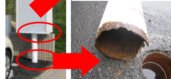
↑柱根元のサビを放置し、倒壊。
