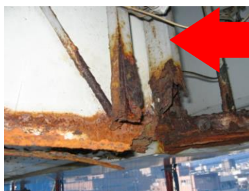
↑板面裏側のサビ、腐食。サビによる腐食はミルフィーユ状に剥がれ崩落する恐れも。
