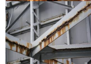
↑内部鉄骨のサビ・腐食。
