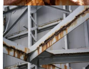
↑内部鉄骨のサビ・腐食。
