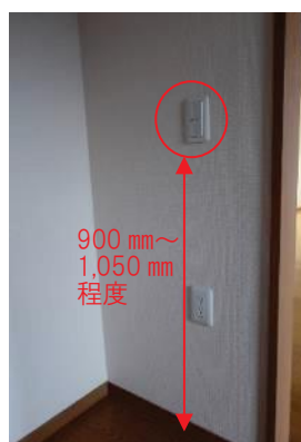
写真Ⅱ.9 子どもの手の届きやすい高さ（床上 1,050 mm 以下）に設けられた電気スイッチ
