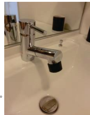
写真Ⅱ.32 洗面台のレバーハンドル式水栓。 伸縮式シャワー水栓でもある
