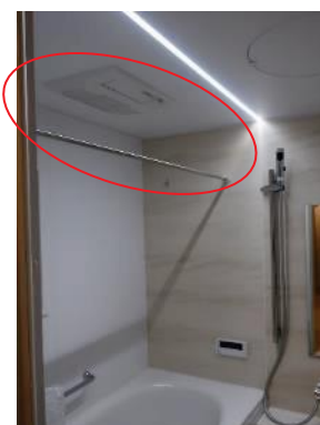
写真Ⅱ.33 浴室の換気暖房乾燥機と 吊り下げ式物干し
