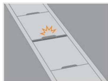
側溝の蓋のすき間
