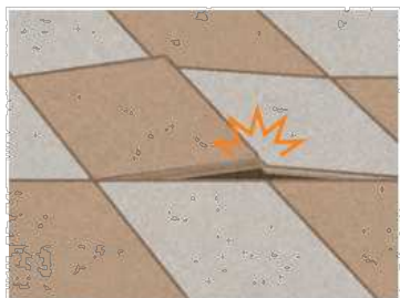
床タイルの浮き
