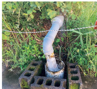
自噴している地下水 （大井川防災広場横）
