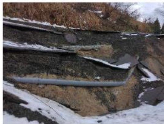
水道水を配水する拠点となる配水池へ送る送水管の被災（輪島市送水管）
