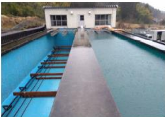
水道水をつくる浄水場の被災（珠洲市宝立浄水場の沈殿池）
