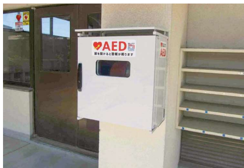
AEDの屋外設置 (三重県津市の小学校)
