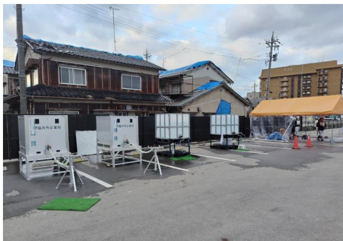
<給水所に設置された仮設タンク>
