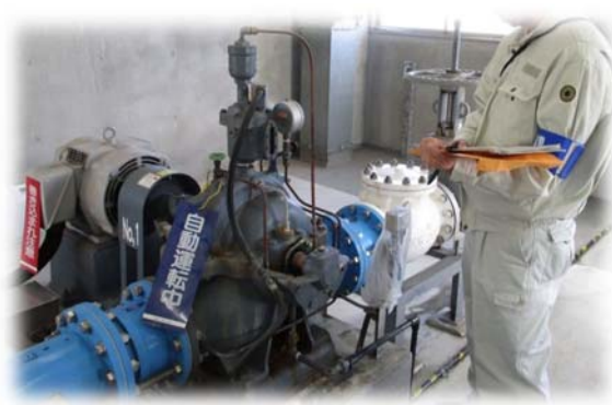
(防災訓練：ポンプ動作確認)
