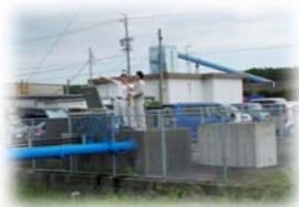
(水源井戸と導水管)
