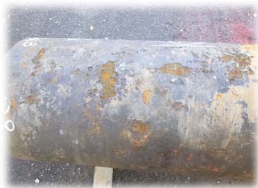
(老朽化した配水本管)
