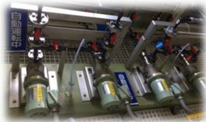
(塩素注入ポンプ)
