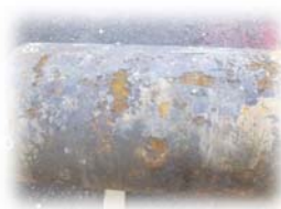
(老朽化した配水本管)
