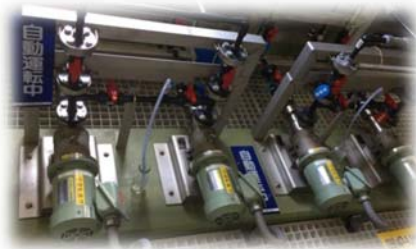
(塩素注入ポンプ)
