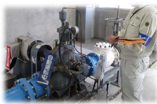
(防災訓練：ポンプ動作確認)
