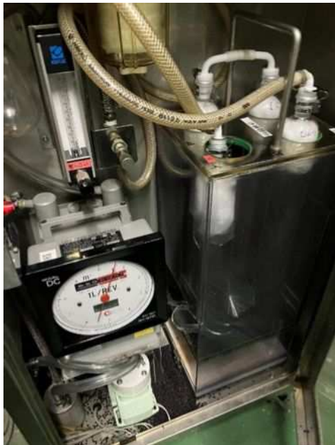
写真1 カラムの破損状況
