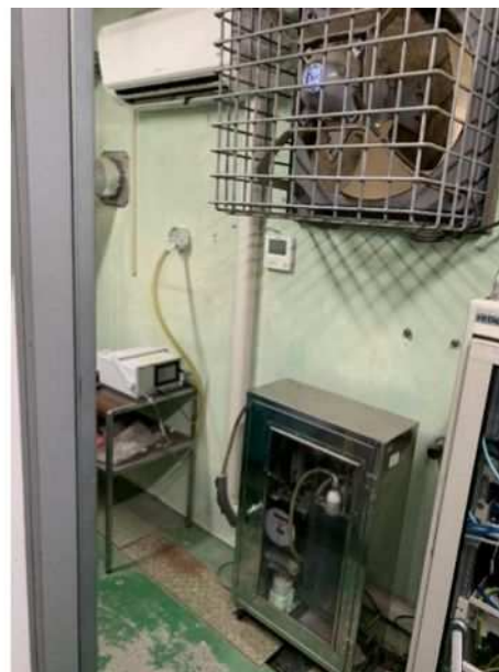
写真5 平場局舎内の状況
