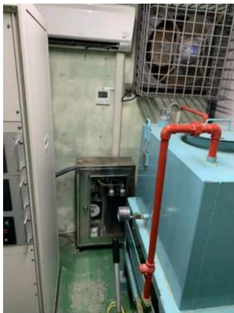
写真4 白砂局舎内の状況
