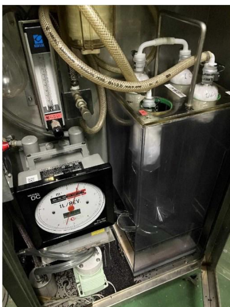
写真1 カラムの破損状況
