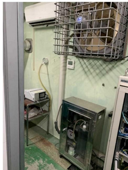
写真5 平場局舎内の状況
