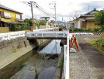
越流に備え土のう常設（小石川）
