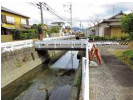
越流に備え土のう常設（小石川）
