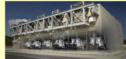
㊀ガスタービン発電機
