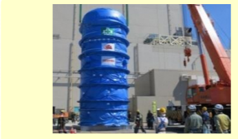
㊈フィルタベント設備(設置前)
