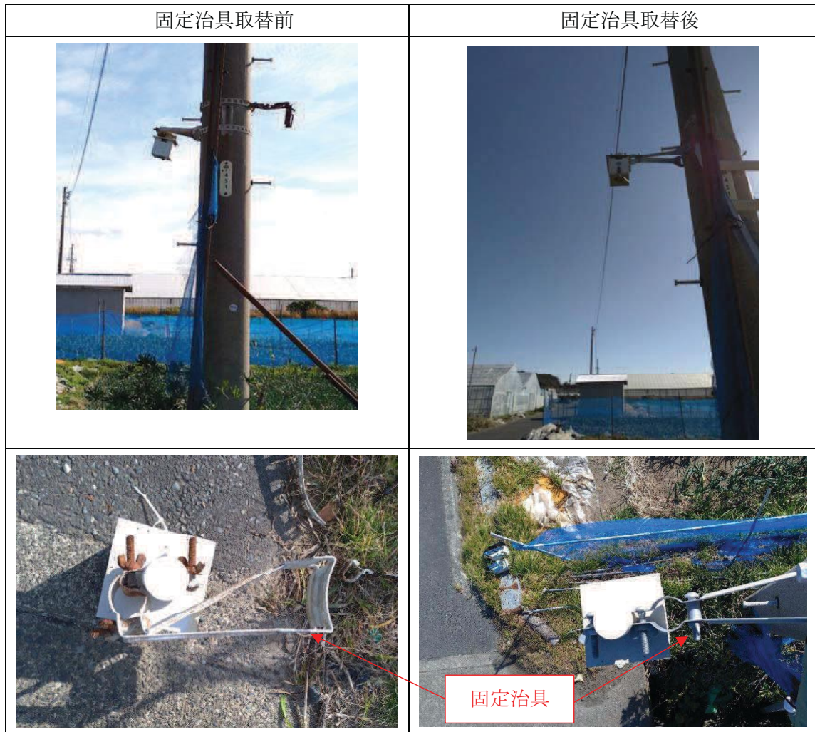
図3 中西のモニタリングポイントの蛍光ガラス線量計固定治具の取替前後の写真
