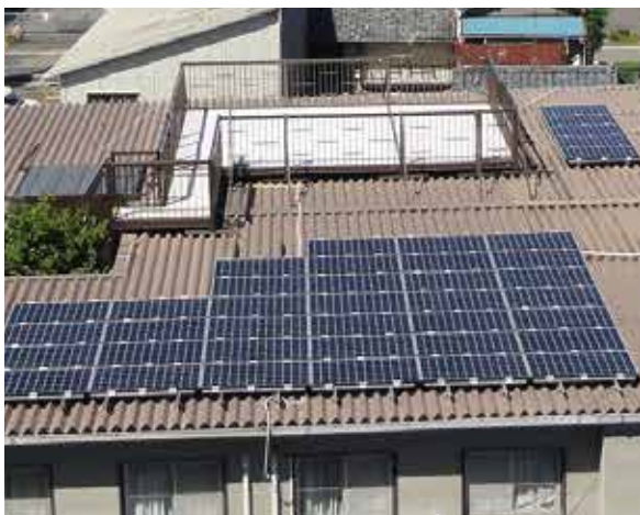
(事例3) 太陽電池モジュール *
