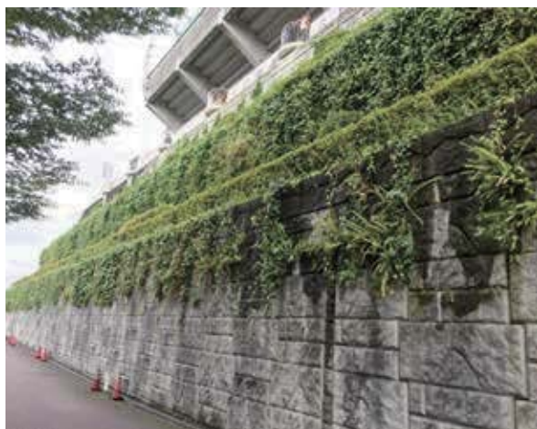
(事例3) ツタ等による被覆
