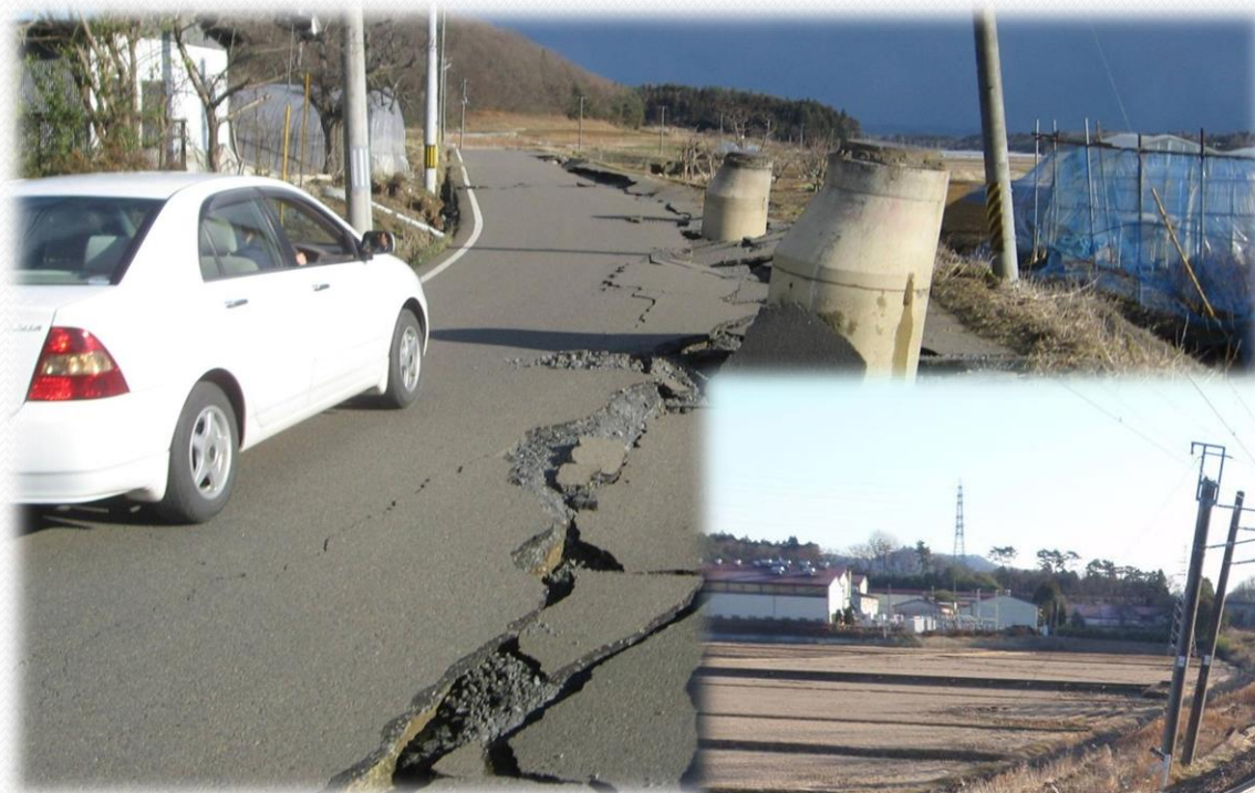
液状化により突き出したマンホール
