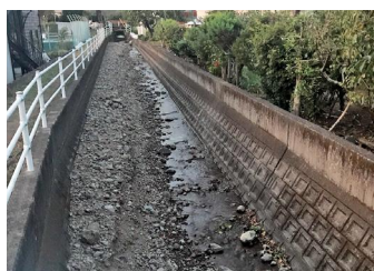
台風15号で大量の土石 (坂本の旭団地公園裏の河川)
